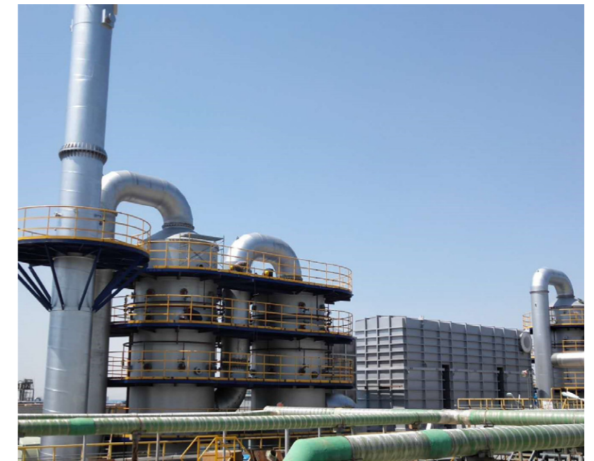
RTO 廢氣焚燒設施
